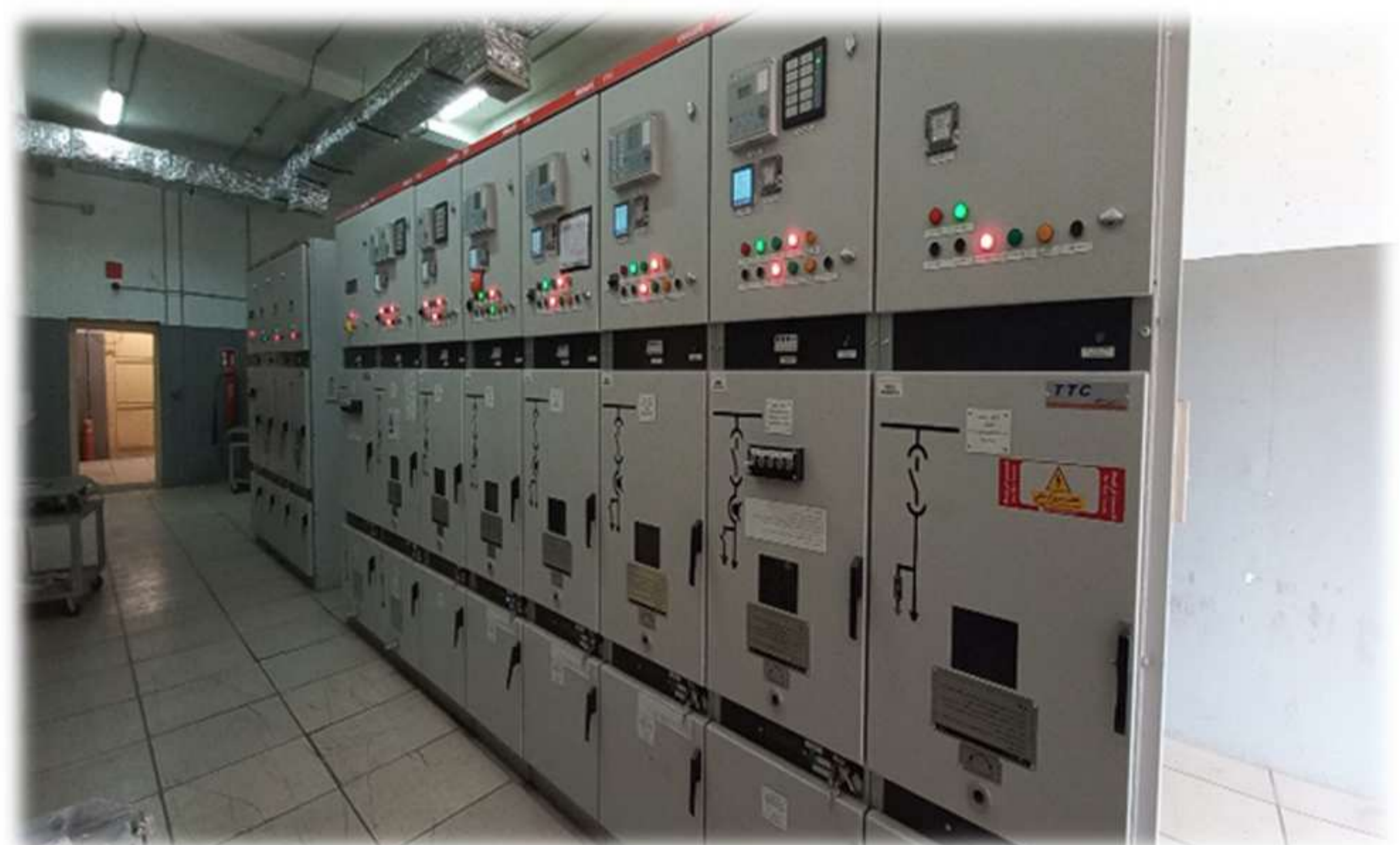
شکل ۹- نمای خارجی تابلو های FTP - MV Switchboard
