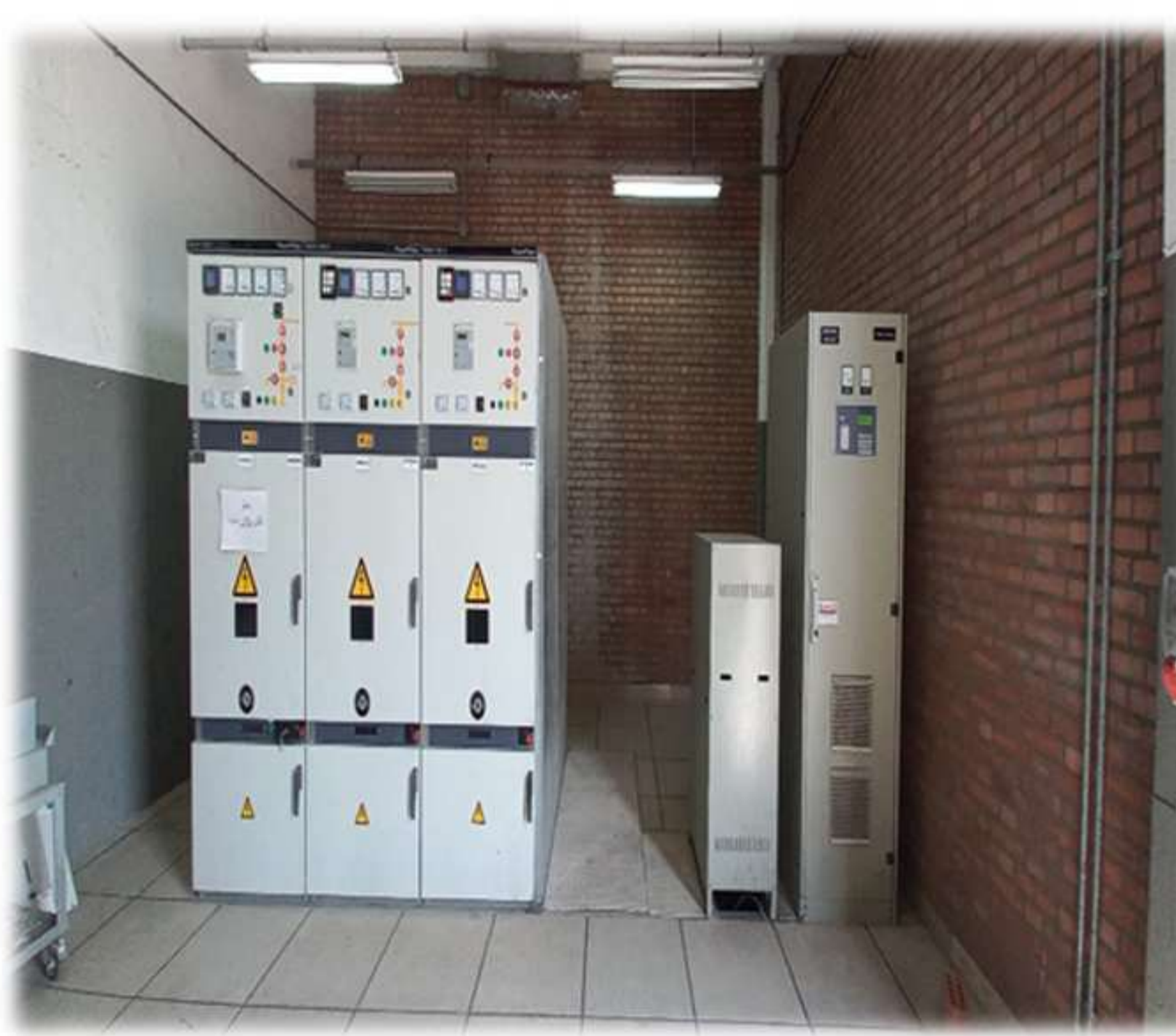
شکل ۱۲- نمای خارجی تابلو های Admin - MV Switchboard
