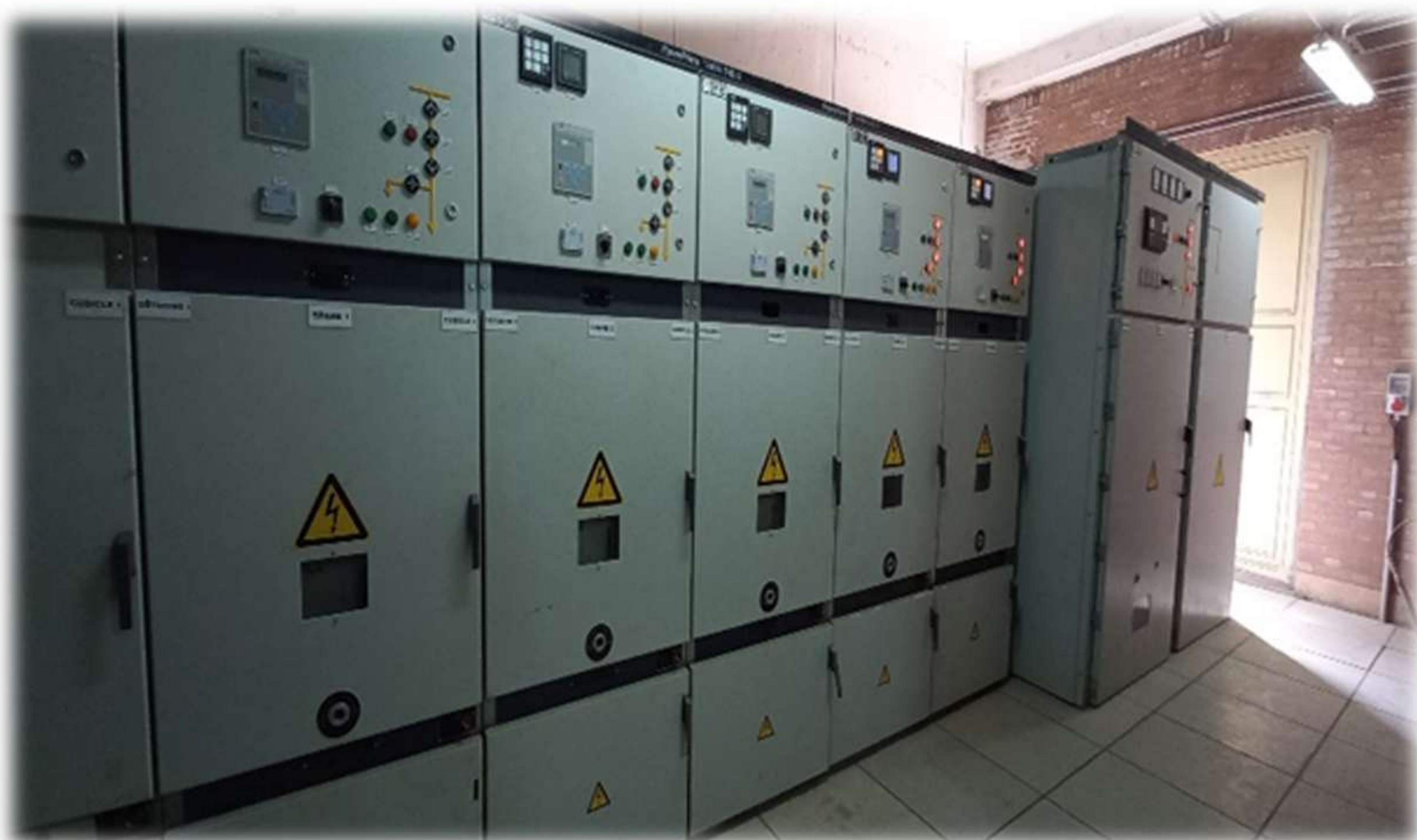
شکل ۱۰- نمای خارجی تابلو های Scrap Yard - MV Switchboard
