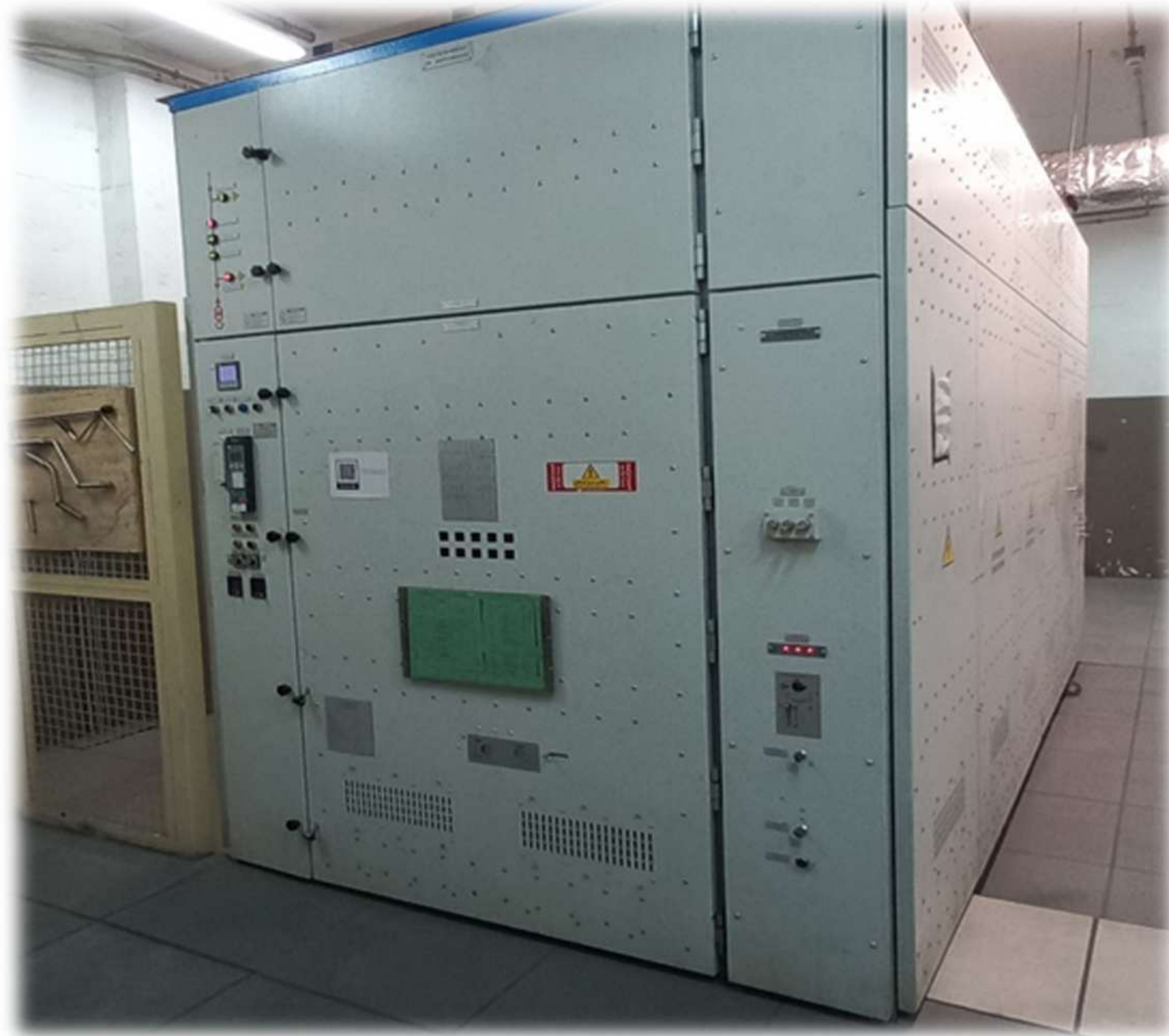
شکل ۷- نمای LRF - MV Switchboard
