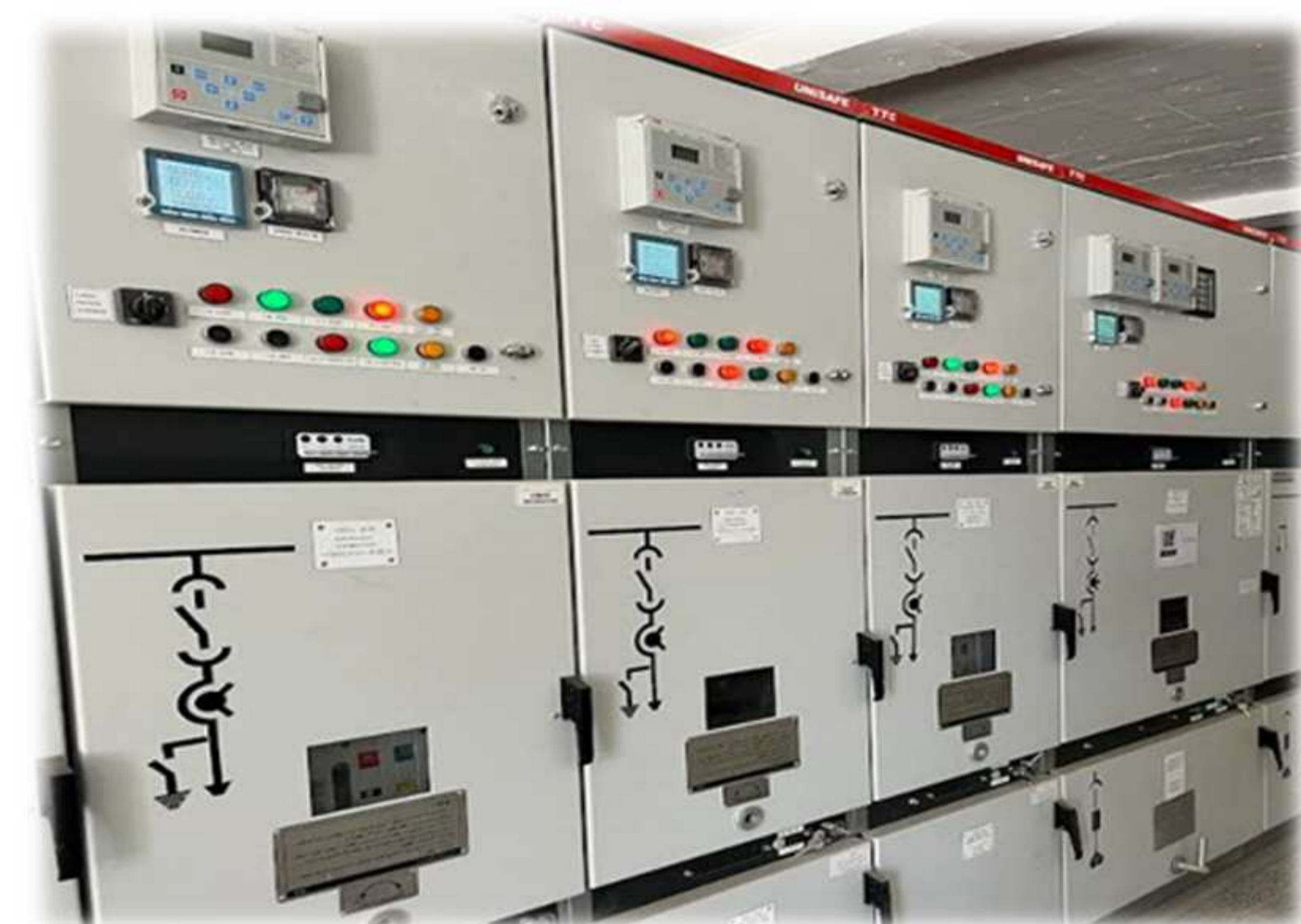
شکل ۱۱- نمای خارجی تابلو های DRP - MV Switchboard
