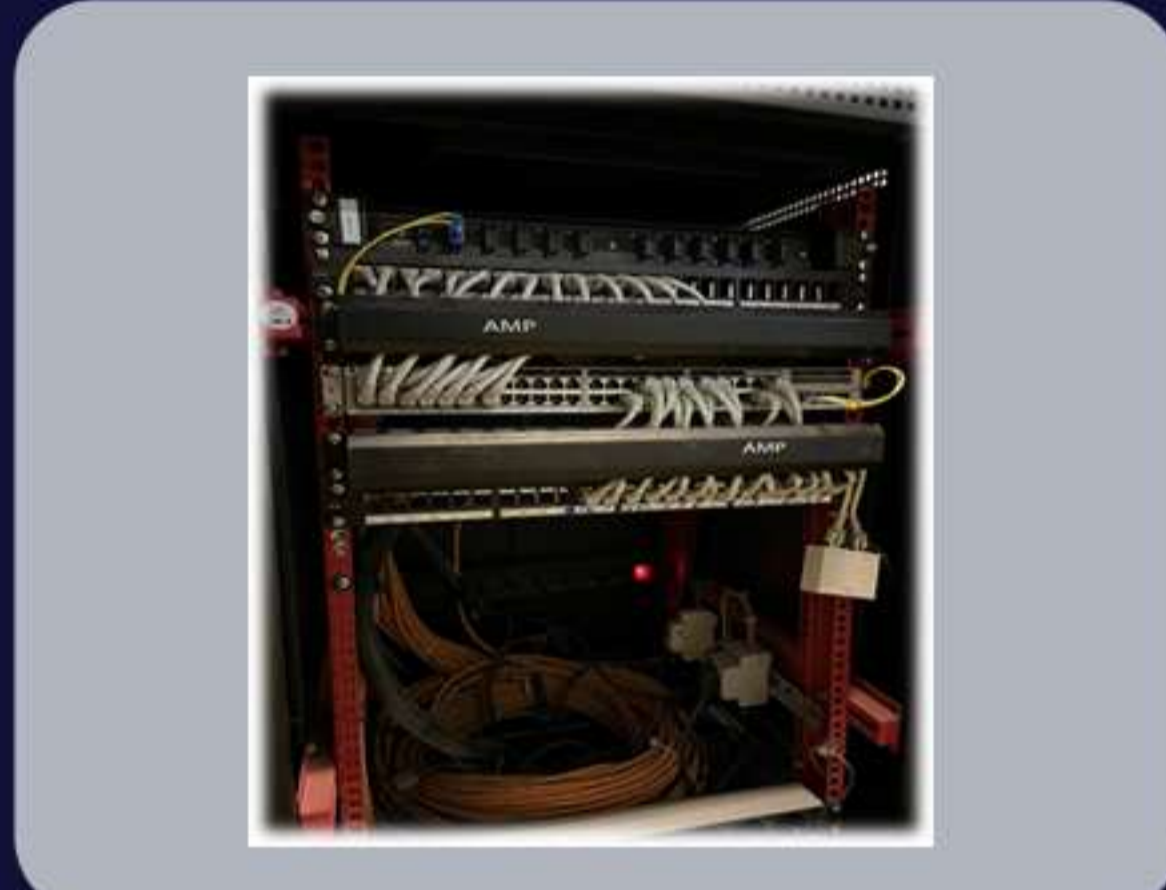
کابل کشی و نصب و راه اندازی تجهیزات UPD سیستم IT کارخانه فولاد سازی
